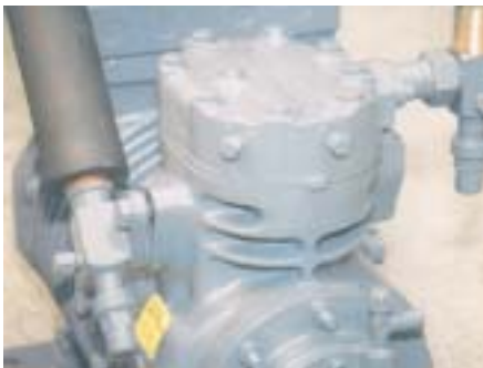
Bilde 1. Sugerør er isolert med cellegummi helt frem til kompressoren for å unngå isdannelse og effekttap.
