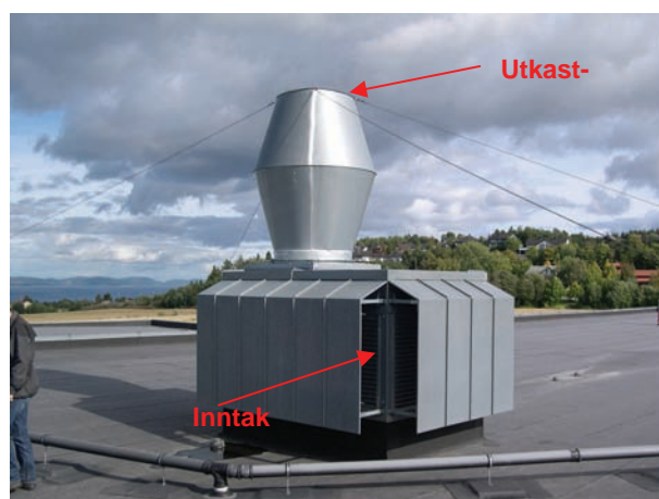
Fig. 4 b Skjernet friskluftinntak på taket. Vertikale inntak på sidene og horisontalt utkast på toppen. Foto: SINTEF Byggforsk
