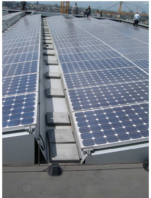
Fig. 8 e Solcellepaneler monterte på små, lette stativer med skjerming. Foto: SINTEF Byggforsk
